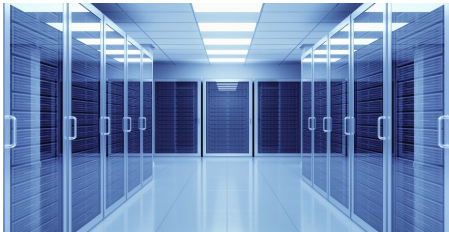
Sala Técnica o Data Center (imagen referencial)
